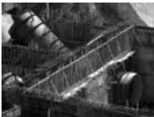
Devecikonađı HEPP Cebri Boru, \phi = 4200 m
